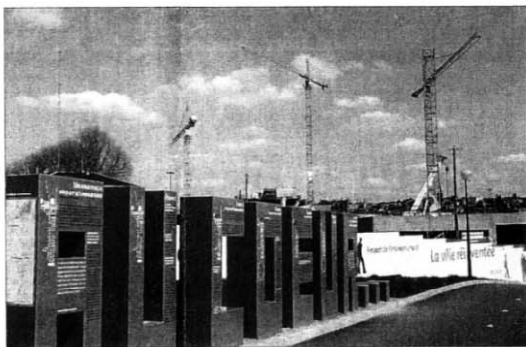
Le chantier du futur centre Pompidou-Metz vient de prendre sept mois de retard supplémentaires.
